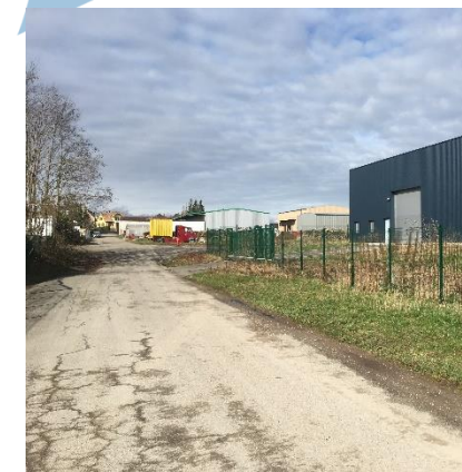
VOIRIE PRÉSENTANT DES FAÏENÇAGES
